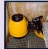
FILTRO A SABBIA VANO TECNICO
