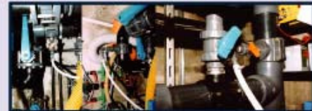
VALVOLE PER DOSAGGIO CLORO
