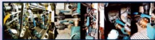
COLLETTORE DI ASPIRAZIONE E DISTRIBUZIONE CON RELATIVE POMPE E VALVOLE
