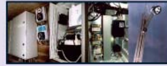
QUADRO AUTOMATISMI, SENSORI DI ALLARME, TELECAMERE VIDEOSORVEGLIANZA
